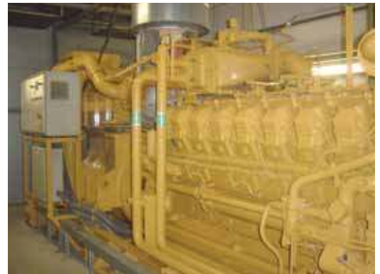
BHKW Modul | CHP module
