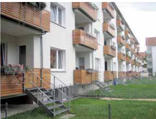
Sanierung im Geschosswohnungsbau in Hannover-Vahrenwald Refurbishment in the apartment block in Hannover-Vahrenwald
